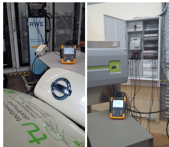
Ausspeisepunkt über SyncMeter an öffentlicher Ladeinfrastruktur (links), Einspeisepunkt über intelligentes Messsystem mit PV-Wechselrichter (rechts)
